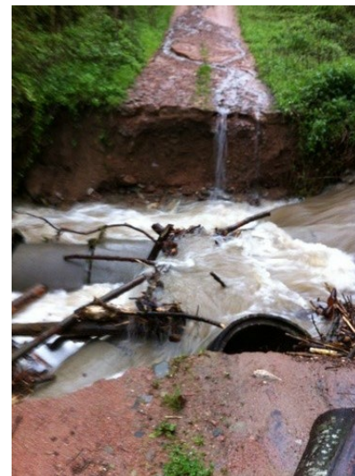
Урушен пропуст на Селачкој реци
